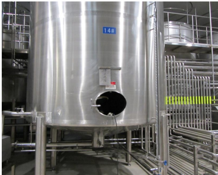
百事可乐工厂工艺管路改造后的现场
